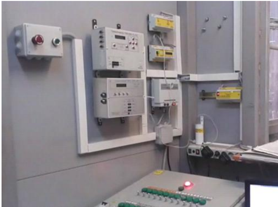
Стендовая база для испытаний батарей топливных элементов внутри комплекса «Феррит» на Приморской учебно-научной базе СПбГМТУ. Пульт системы контроля атмосферы в помещении стенда.
